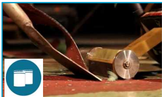
タンク：ガラスフレークライニング
