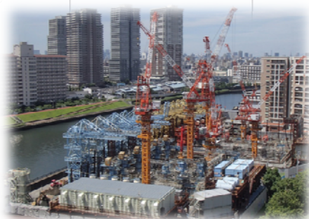
千住関屋ポンプ場
