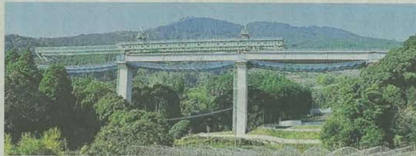
建設が進む住吉橋。緑色の大きな機械で橋げたを設置していく
